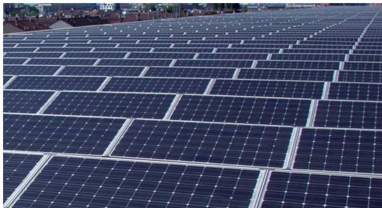
Müssen gefördert werden: Solarpaneele, hier auf der Messe Basel.
